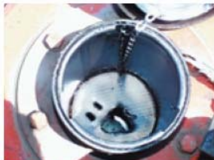
図 3. 不適切な作業工程のため、フィルター・ネック・スクリーンに穴が開いた状態
